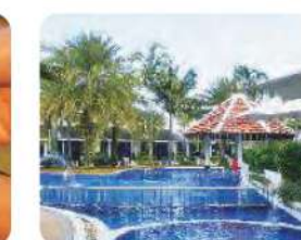
Pompe de filtration pour piscine
